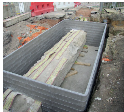
Størrelsesmessig har Ultima Connect i prinsippet ingen begrensninger. Her ses den rundt en eksisterende høyspent trasé. Trekkekummen på bildet måler 5,6 x 2,5 x 1,6 m.
